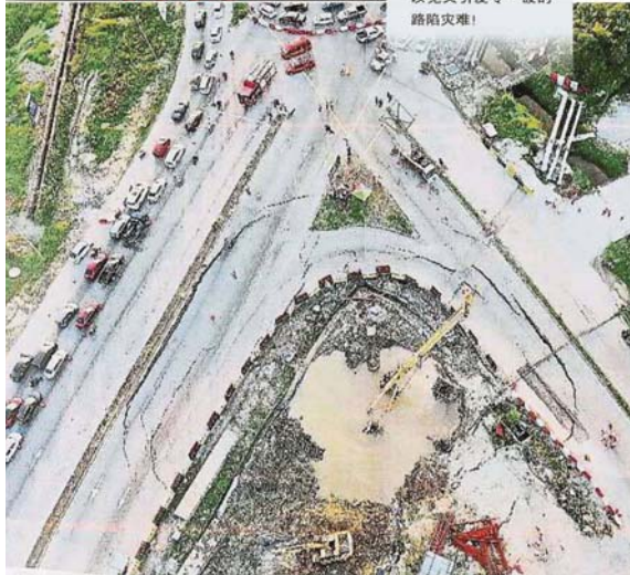
路陷下陷部分以打桩机为中心，呈“圆形”，所以土地移动现象只涉及周围范围内，外围土壤没受影响。
