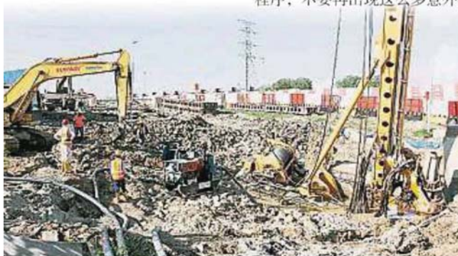
昨晚承包商在该区进行打桩工作，不料却发生路陷事故。
