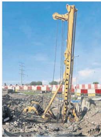
地陷后，打桩机也陷入地里。
